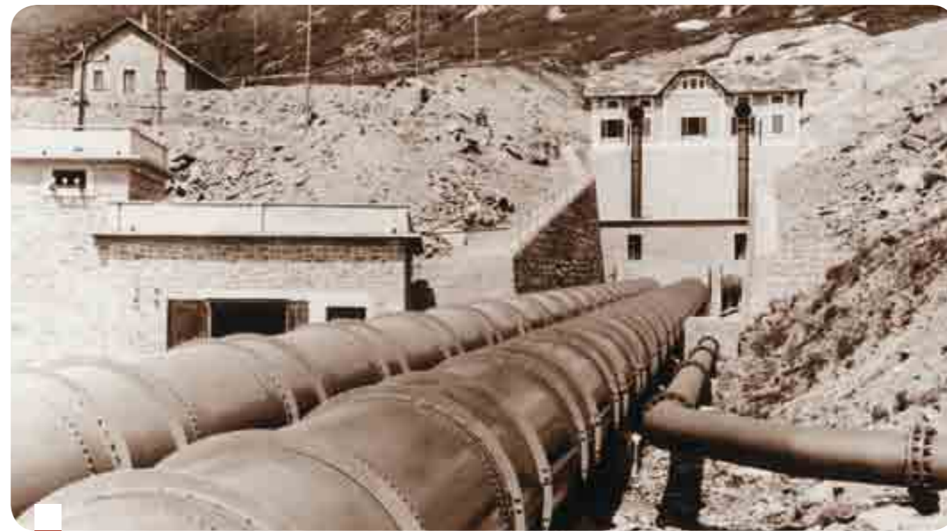
Realizzazione delle vasche di carico di Parebella ed inizio delle condotte forzate
