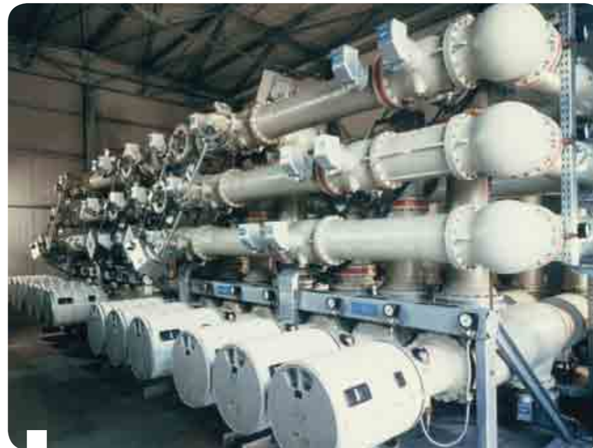
Stazione Monterosa: nuova apparecchiatura in esafluoruro di zolfo
