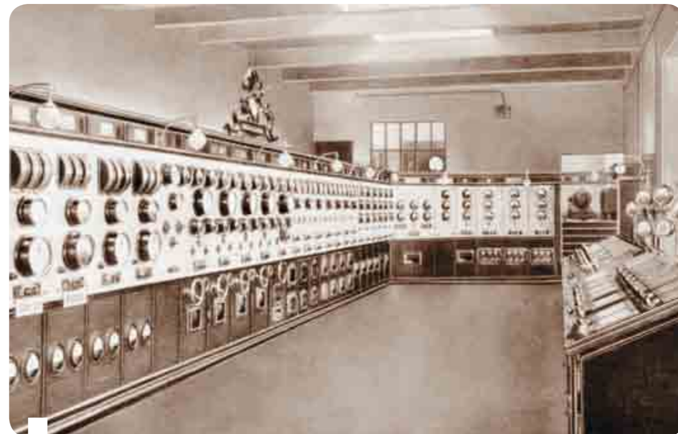
Quadro di manovra della centrale del Martinetto
