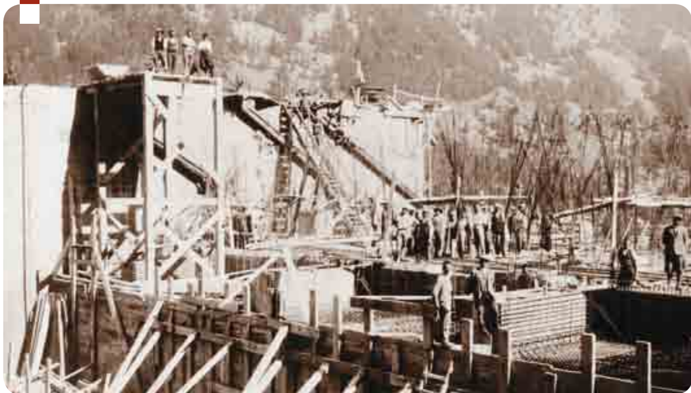
Realizzazione degli auto livellatori e delle paratoie automatiche della diga di Ceresole
