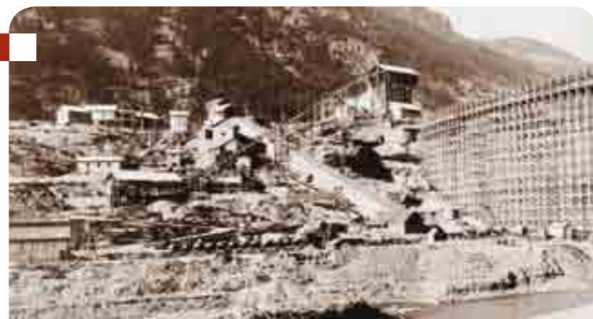
Montaggio della struttura della diga con, a sinistra, le infrastrutture del cantiere
