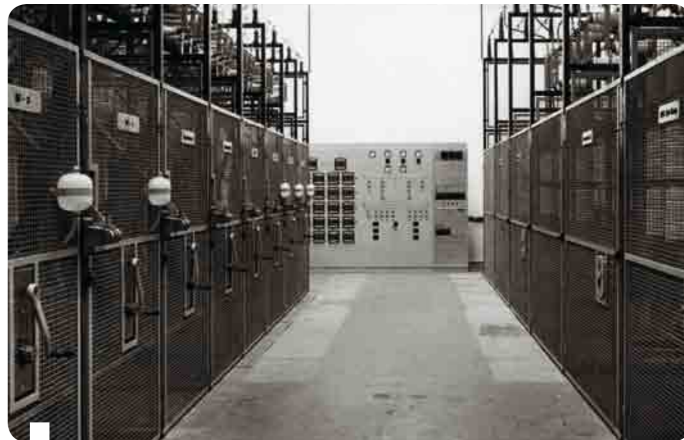
Interno della cabina primaria di Parco Ruffini
