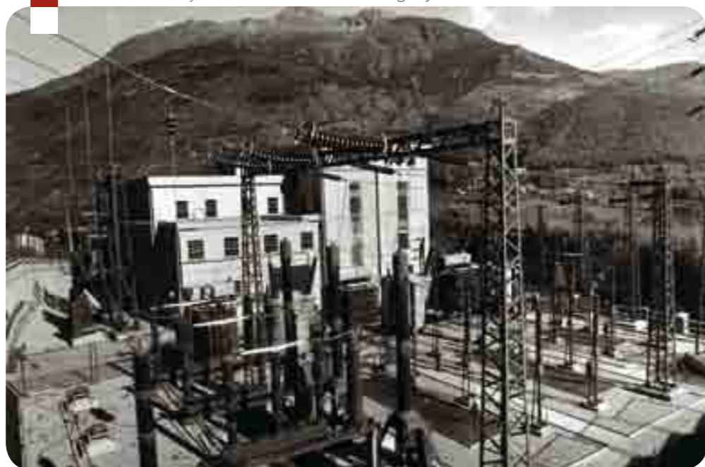
Stazione di trasformazione e centrale di Signayes
