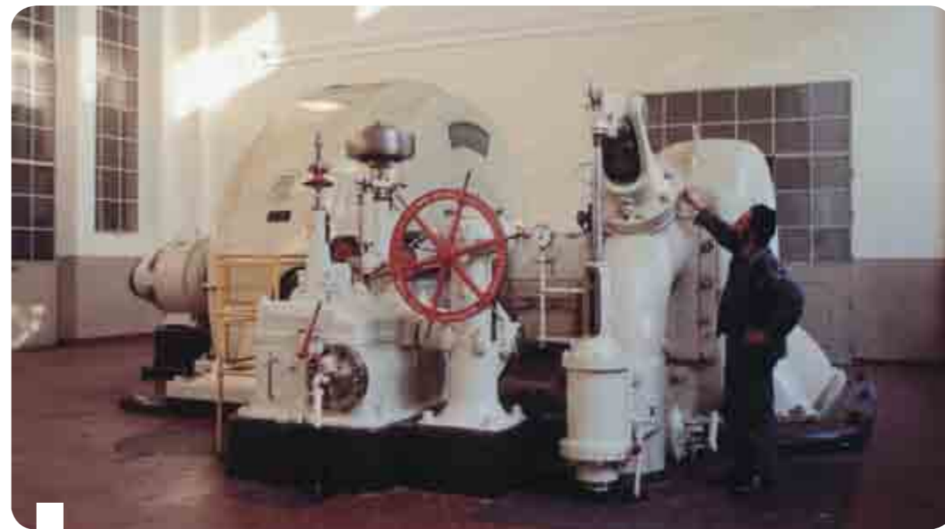
Interno della centrale di Chiomonte
