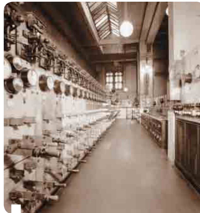
La stazione di conversione di via Bertola
