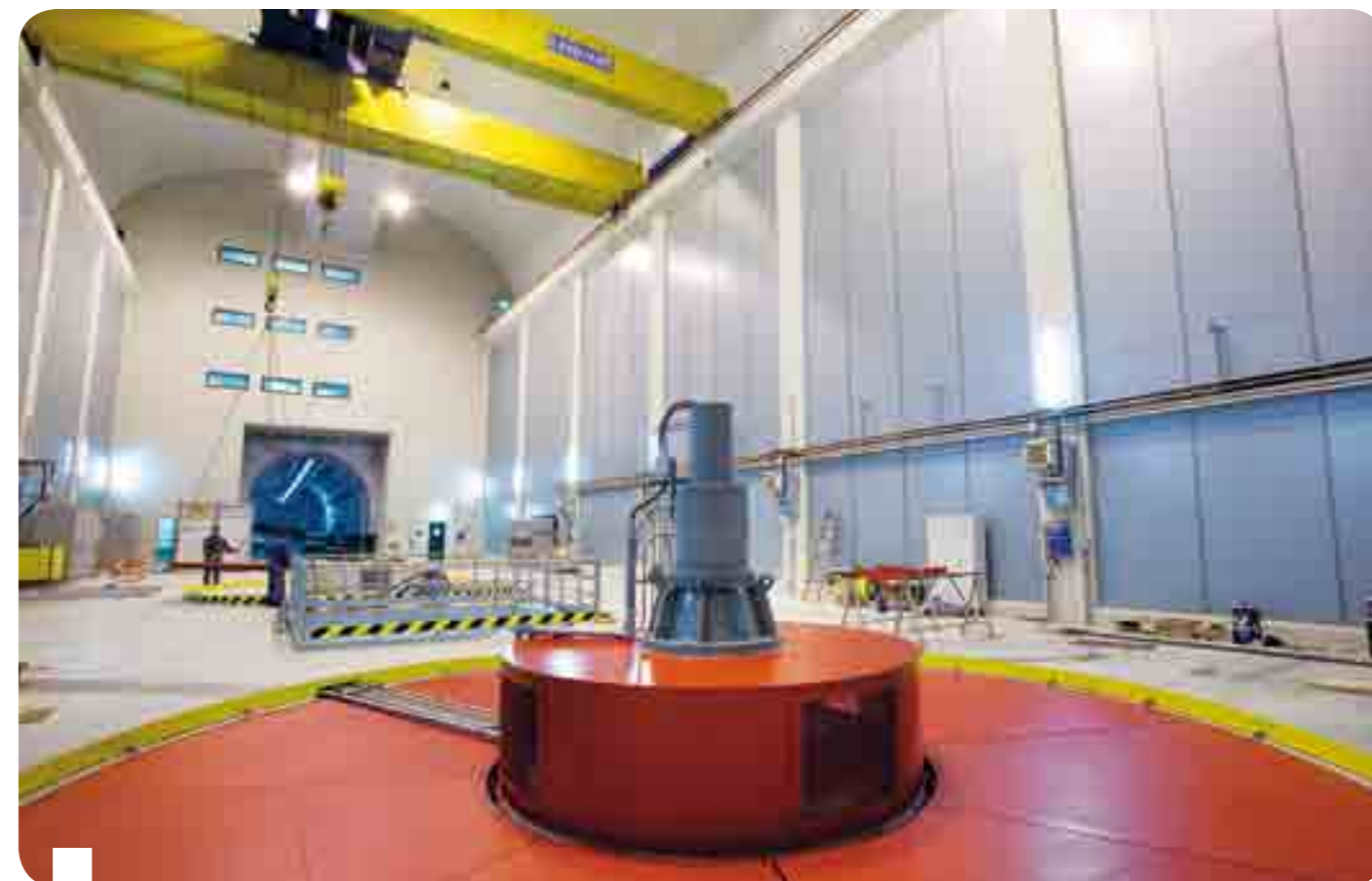
Impianto Pont Ventoux-Susa: centrale in caverna
