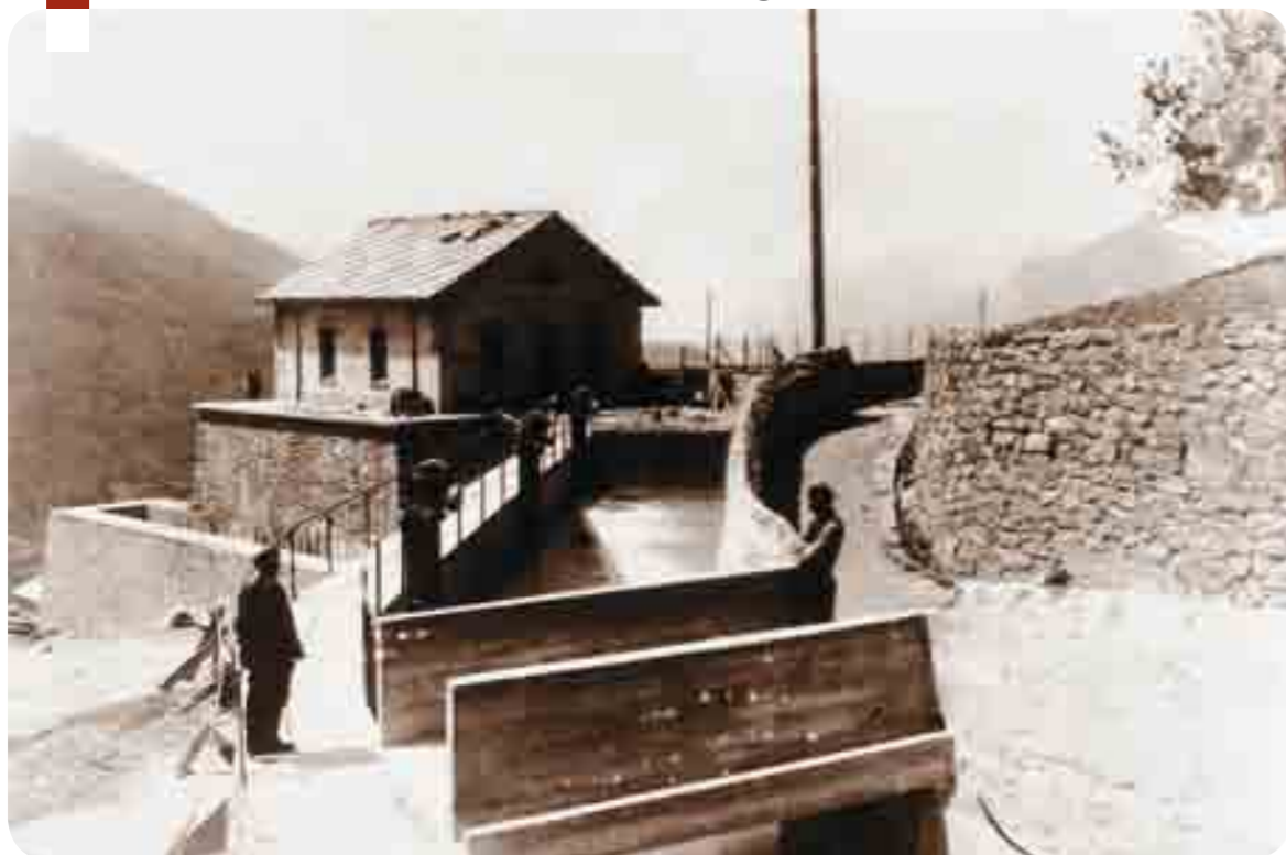
Il canale d'accesso al bacino della Ramat e la casa dei guardiani in costruzione
