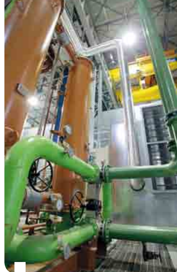
Un interno dell'impianto 3° GT
