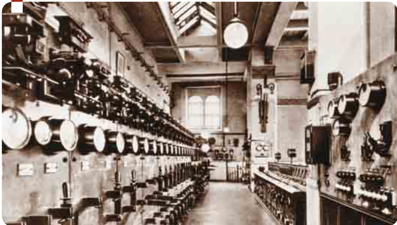
La sala quadri di manovra della stazione di conversione di via Bertola
