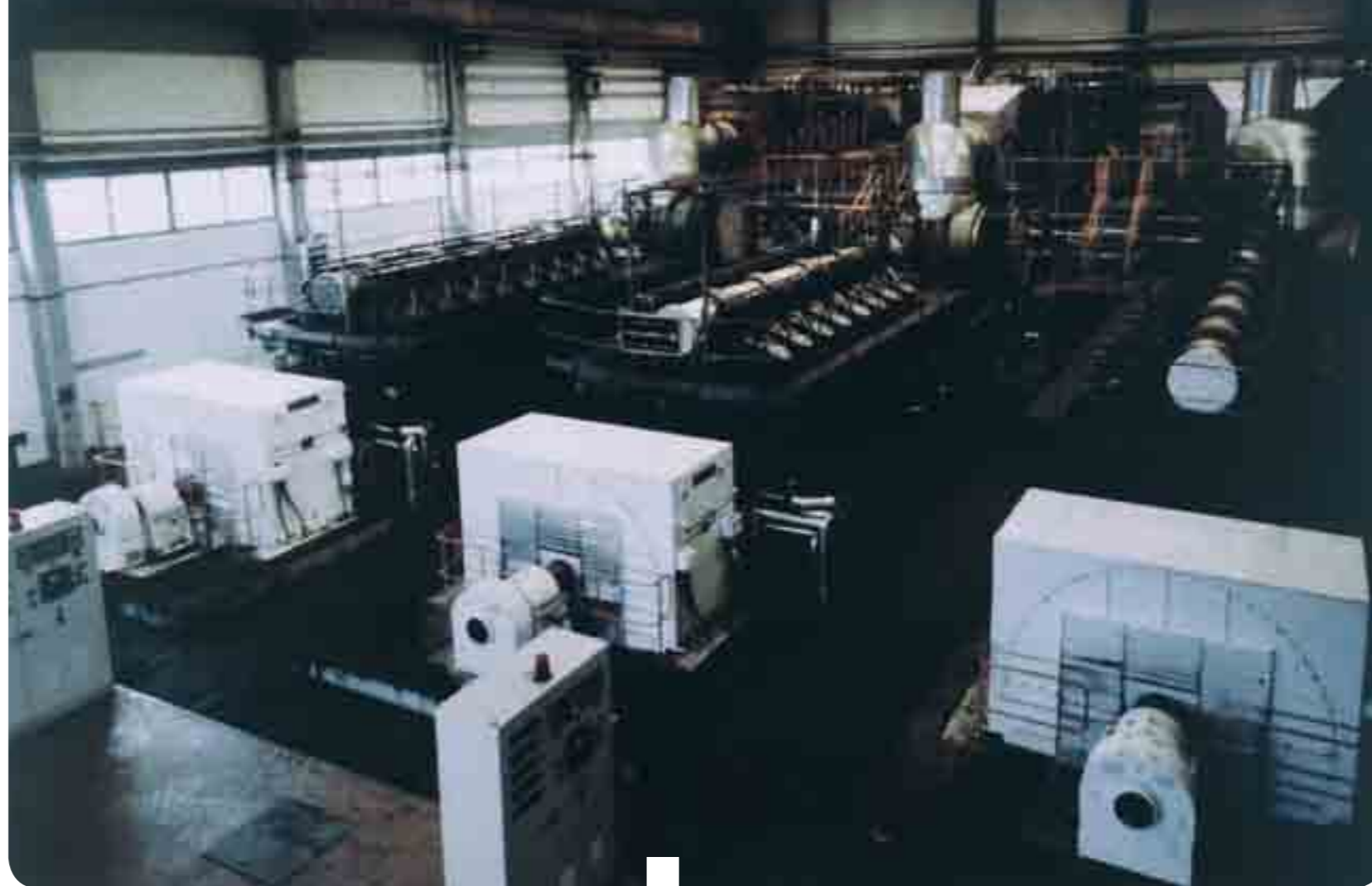
Interno della centrale Le Vallette
