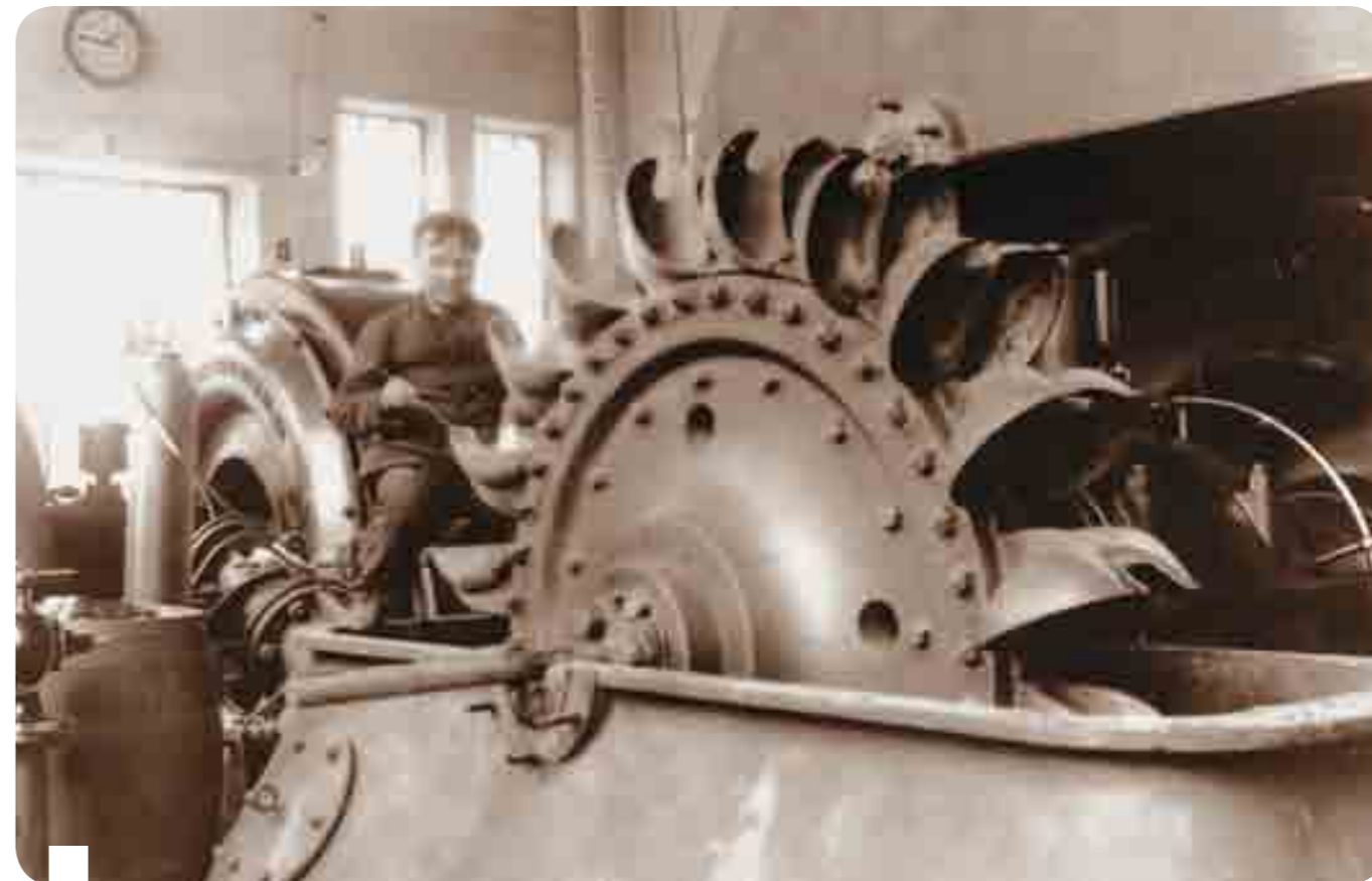
Manutenzione dei gruppi nella centrale di Chiomonte
