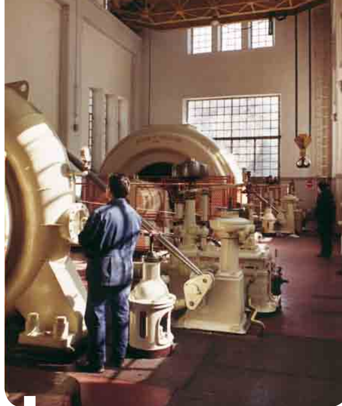
Interno della Centrale di Susa
