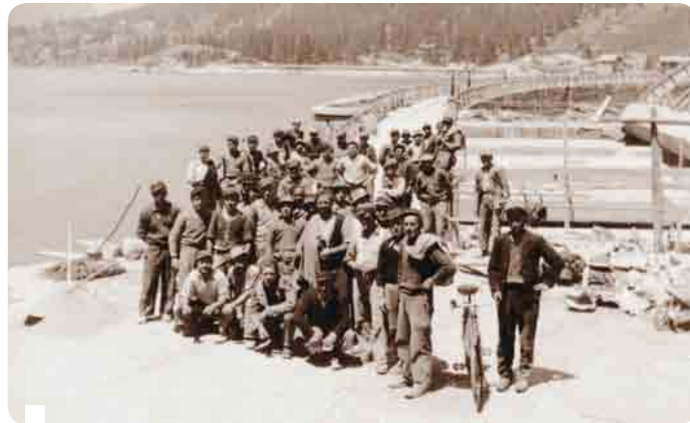
Il gruppo della maestranze impegnate nell'ultimazione degli autolivellatori e delle paratoie automatiche della diga di Ceresole
